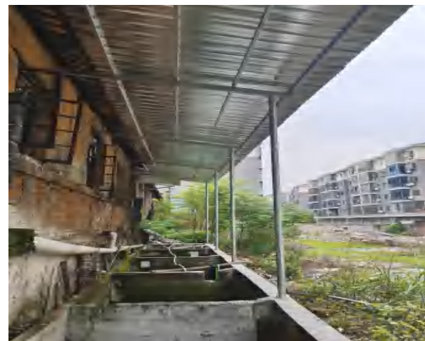
污水处理站遮雨棚
