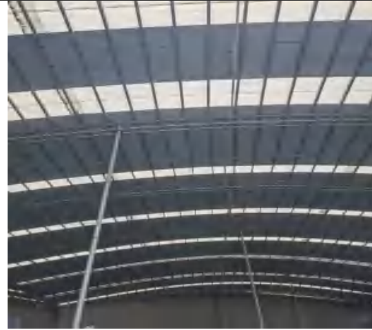
堆场喷淋系统
